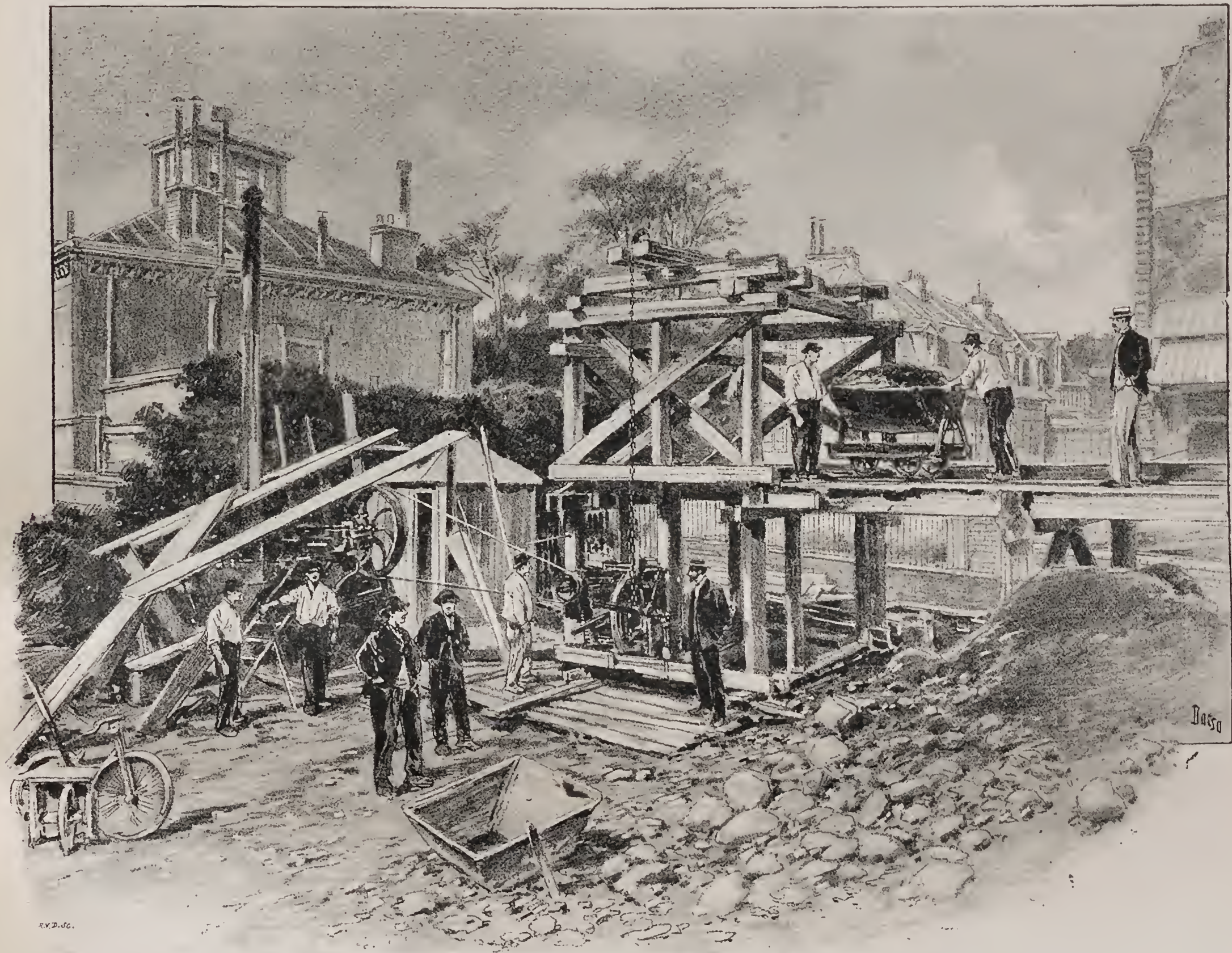
LA LIGNE COURCELLES-CHAMP-DE-MARS. — Puits, avec monte-charge, établi dans le jardin d'une propriété acquise par la Compagnie (Chaussée de la Muette).
